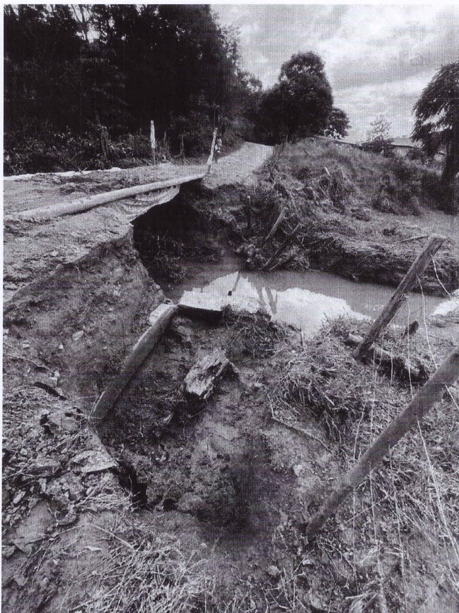
Foto 01: Mostra o cabresto da ponte totalmente destruído, além de uma ponte provisória que foi feita pelos moradores, porém, interditada pela prefeitura.
