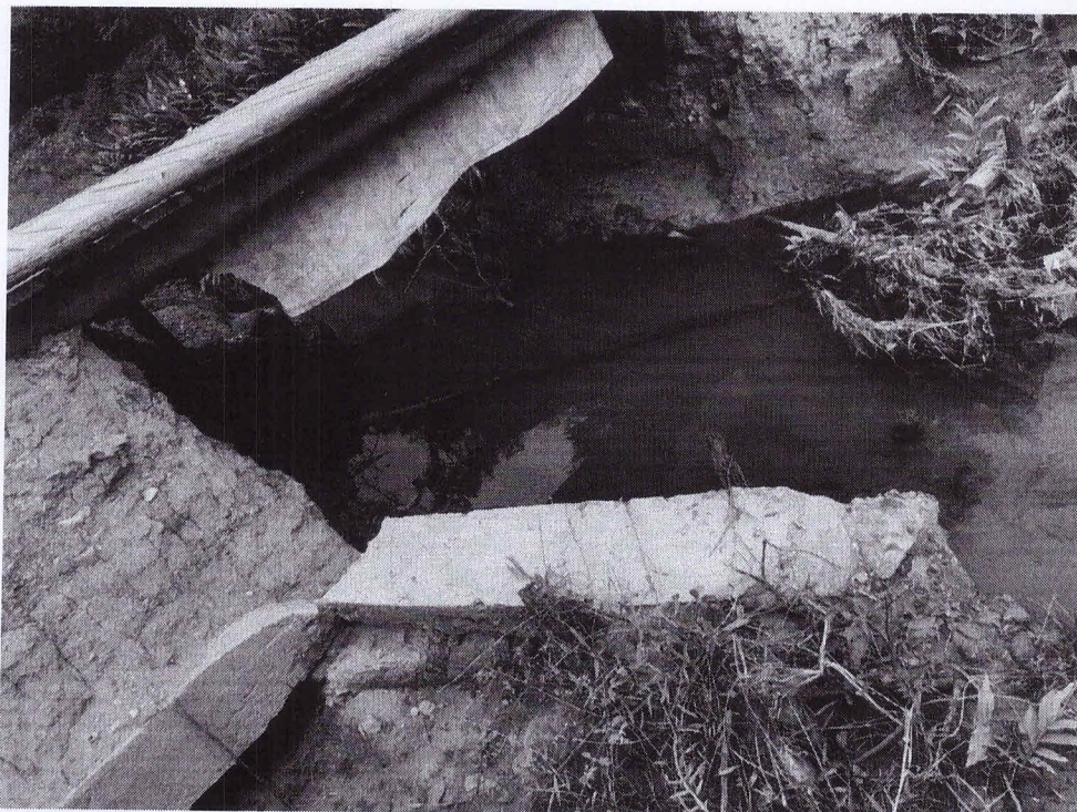
Foto 03: Mostra a estrutura danificada, restando no local apenas parte de um dos cabrestos.
