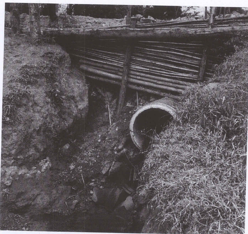
Foto 03: Contenção refeita por moradores apresenta falahs construtivas e tras riscos ao uso.
