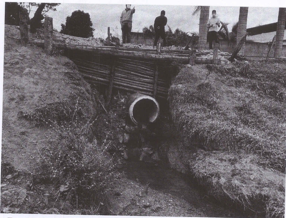
Foto 02: Bueiro circular refeito por moradores, porem de forma incorreda.
