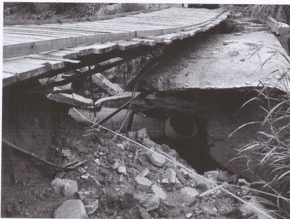
Foto 02: Mostra o manilhamento descontinuo.viga de travamento dos cabrestos quebrada e carreamento de materia utilizado como mesoestrutura.
