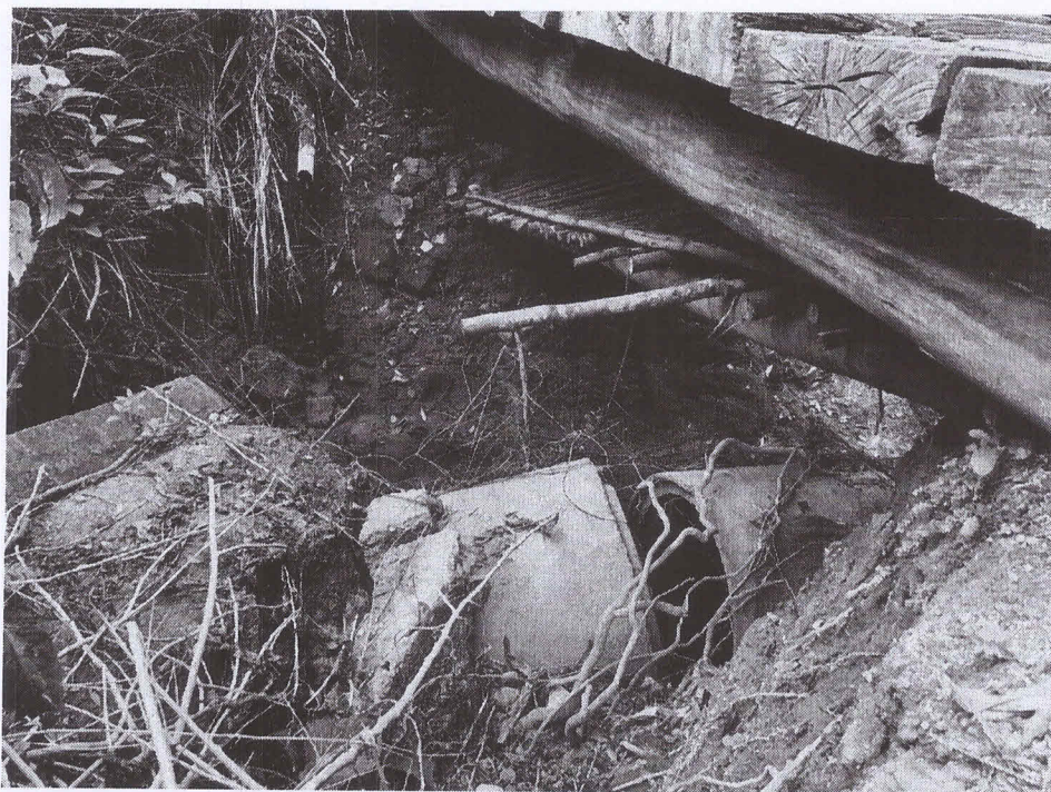
Foto 03: Mostra parte do manilhamento ainda no local, todo danificado, além de uma estrutura provisória, que foi interditada pela prefeitura (veio a ruina) e novamente fizeram nova estrutura (população da localidade).
