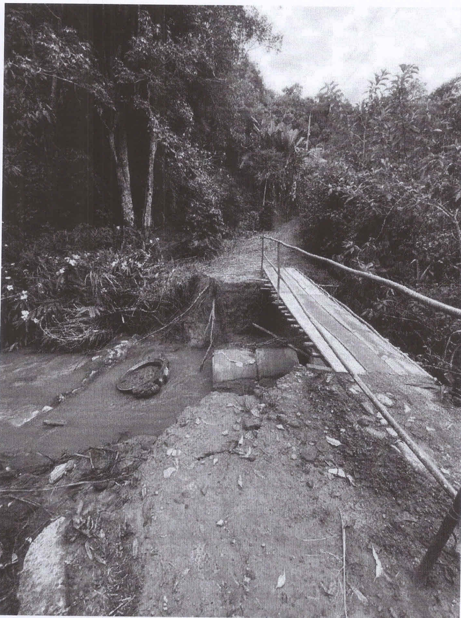
Foto 01: Mostra parte do manilhamento ainda no local, todo o aterro e cabeceiras levadas pela chuva, além de uma estrutura provisória, que foi interditada pela prefeitura.
