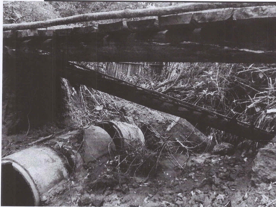
Foto 02: Mostra parte do manilhamento ainda no local, todo danificado, além de uma estrutura provisória, que foi interditada pela prefeitura (veio a ruina) e novamente fizeram nova estrutura (população da localidade).
