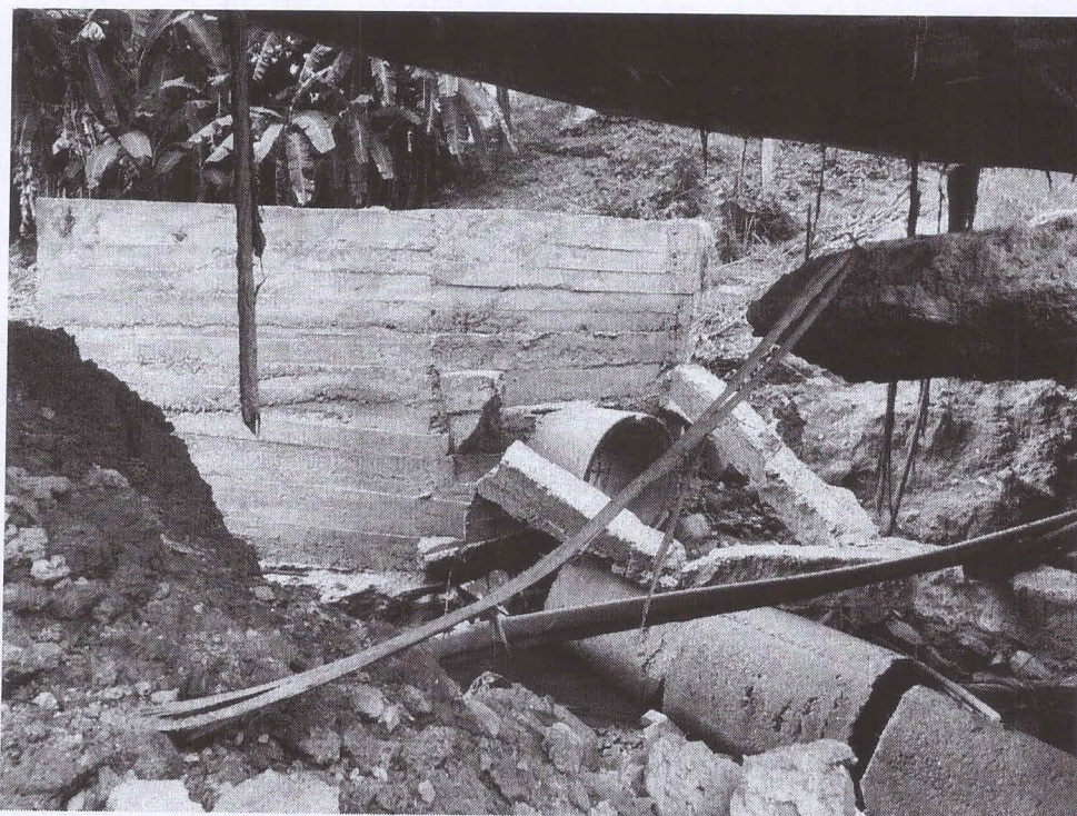
Foto 02: Mostra o manilhamento descontinuo e uma viga de travamento dos cabrestos quebrada. A estrutura é composta por bueiro circular TRIPLO.
