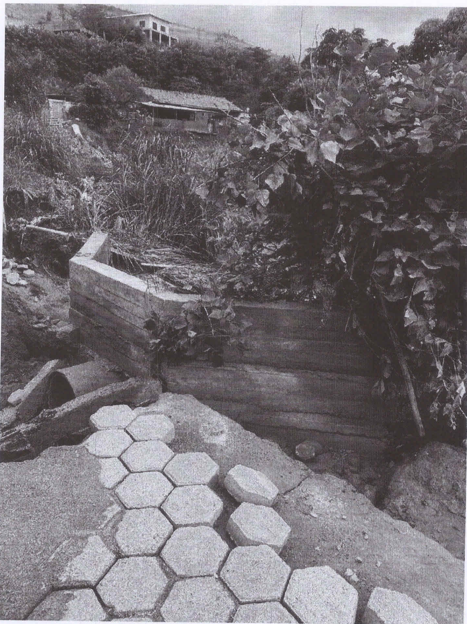
Foto 01: Mostra o manilhamento descontínuo e uma viga de travamento dos cabrestos quebrada.
