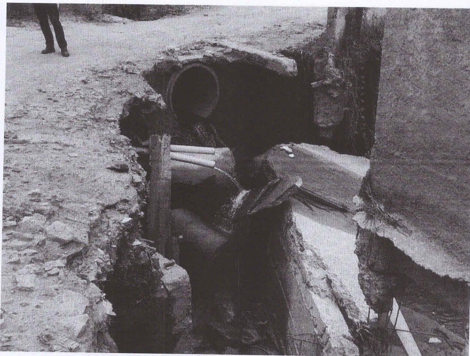
Foto 03: Rompimento da cabeceira da ponte e manilhas.
