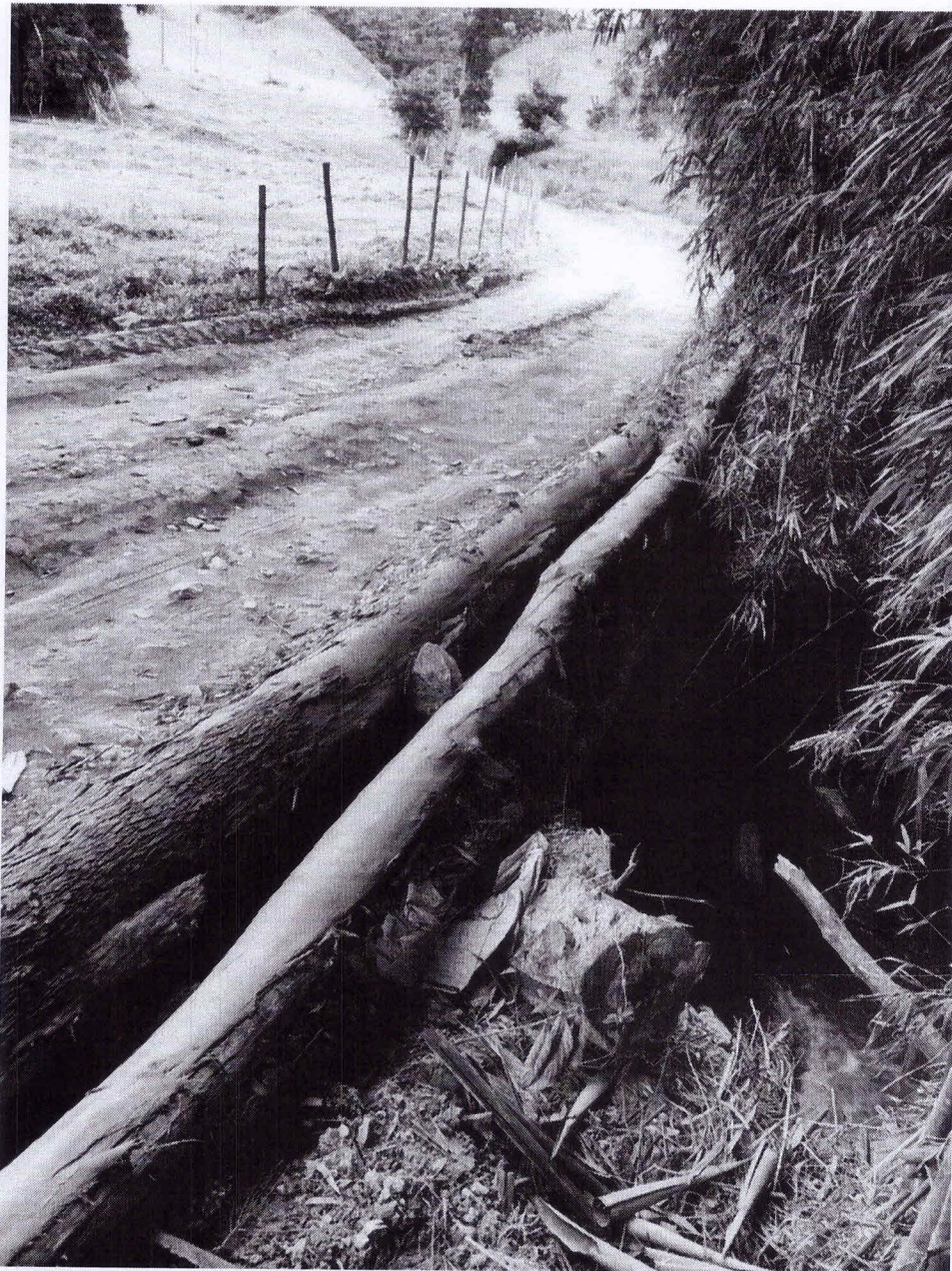
Foto 01: Mostra a ponte totalmente destruída, acesso provisório feito por moradores (não apresenta estabilidade estrutural).
