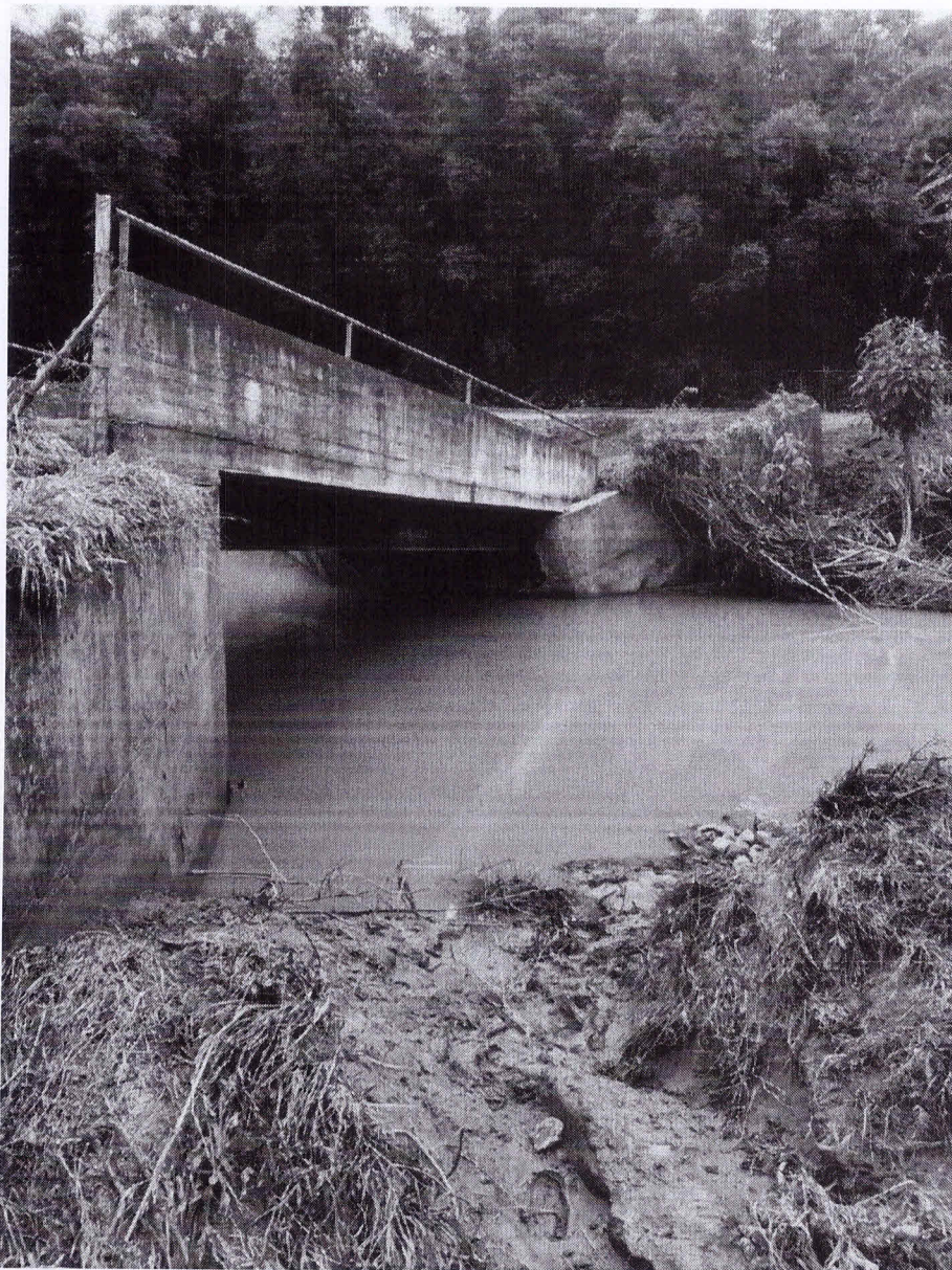
Foto 01: Mostra o cabresto da ponte totalmente destruído, fazendo com que a ponte viesse a se romper.
