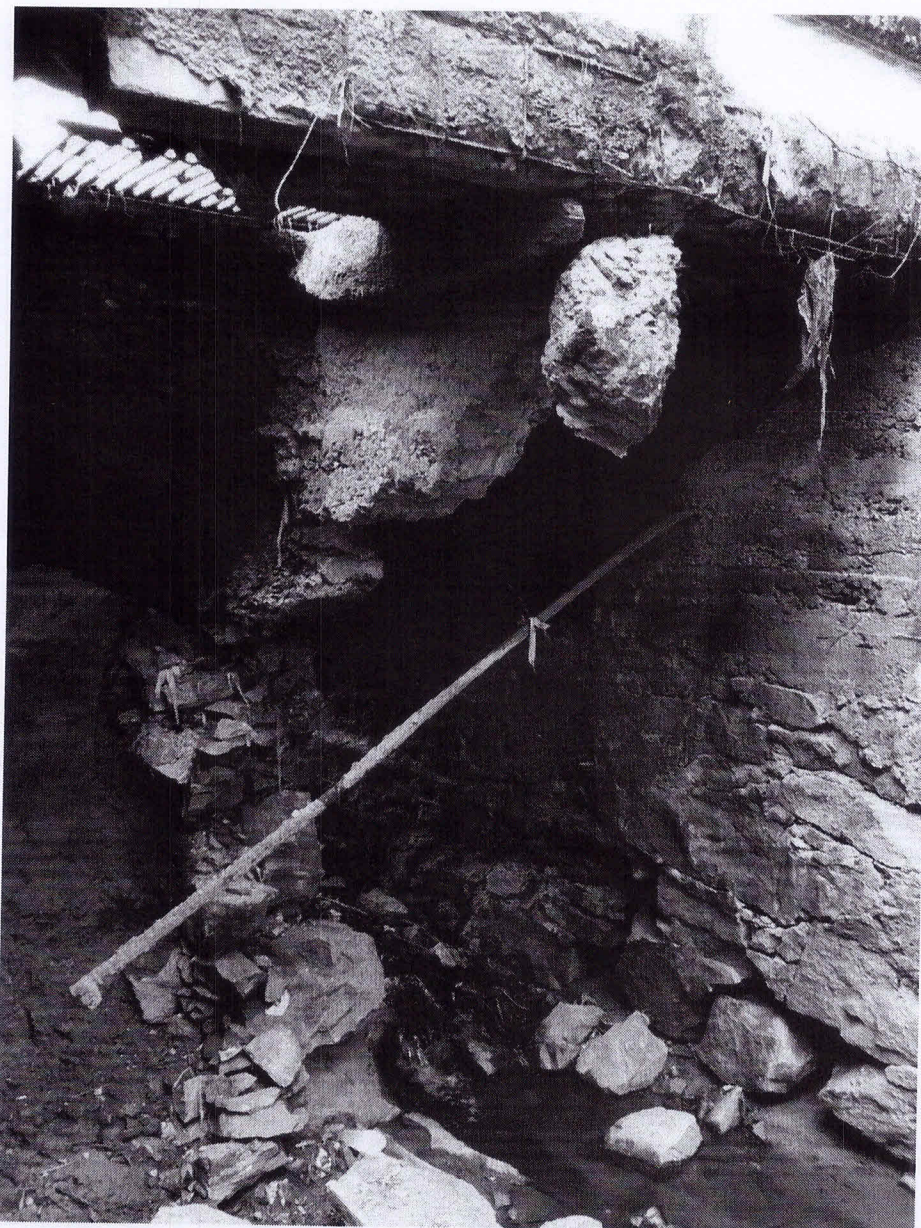
Foto 01: Desmonte de um dos lados de sustentação da ponte.
