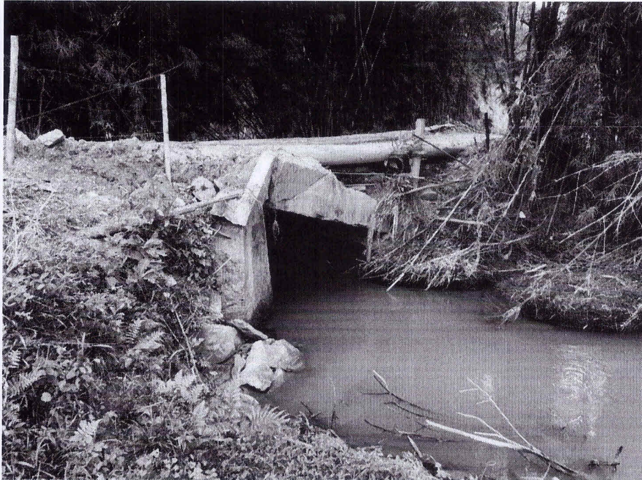
Foto 02: Mostra o cabresto da ponte totalmente destruído, fazendo com que a ponte viesse a se romper.
