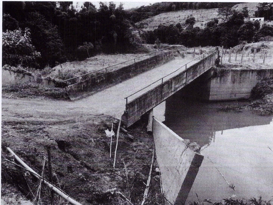
Foto 02: Mostra o cabresto da ponte totalmente destruído, a mesa da ponte e o outro cabresto estão intactos.
