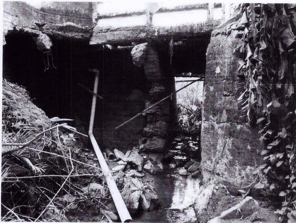
Foto 02: Desabamento da cabeceira da ponte e abertura de cratera, tirando totalmente a estabilidade da via acima.
