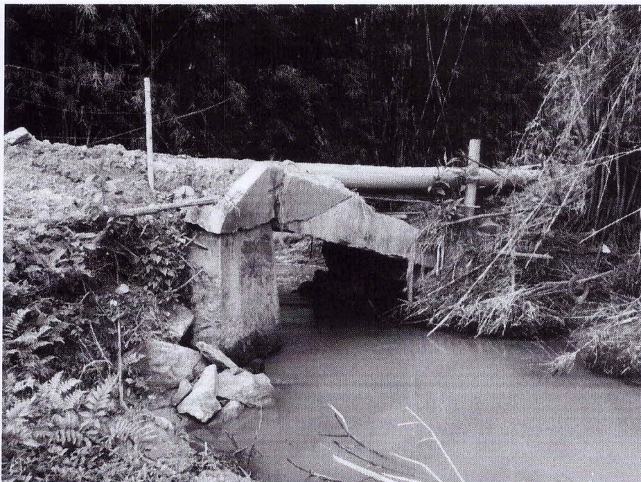
Foto 03: Mostra a ruína dos cabrestos.
